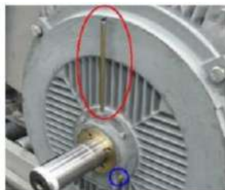
Figura 7. Punto graseo de un motor eléctrico para engrase.
